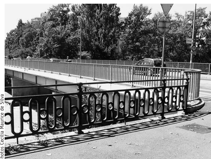
Pont de la Fontenette : difficile raccord entre le séduisant motif des barrières anciennes longeant la berge et les nouvelles barrières métalliques à barreaux verticaux du pont.
